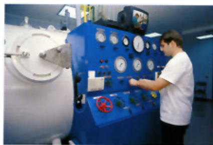
Figura 14. La presurización de la cámara se realiza desde el cuadro de mandos situado en el exterior.
